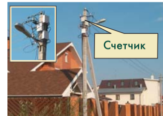
Передача данных со счетчиков по проводам 220В и радиоканалу.
